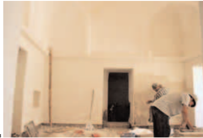
53-54. Ancienne mosquée en cours de restauration, juillet 2004, intérieur et extérieur 55/57. Phase de restauration de l'extrados de la coupole, juillet 2004
