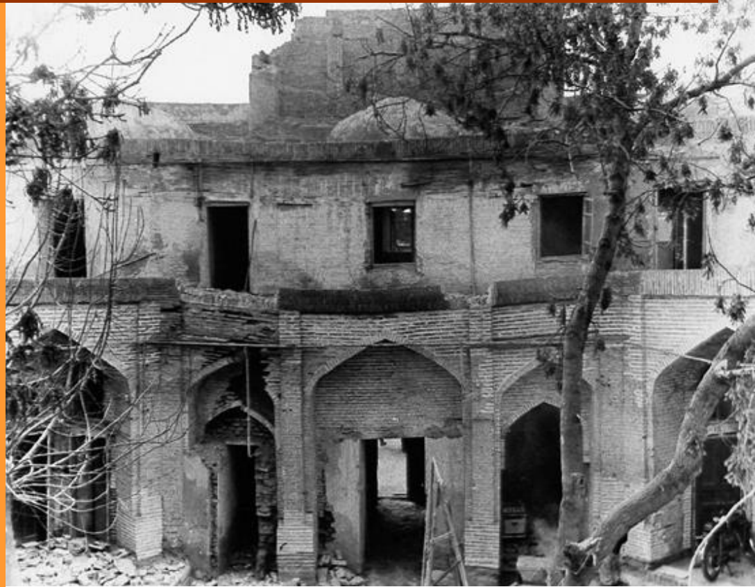
façade intérieure de la cour de la medrese Rashid vers 1960 : on constate l'état déplorable de la structure maçonnée.
